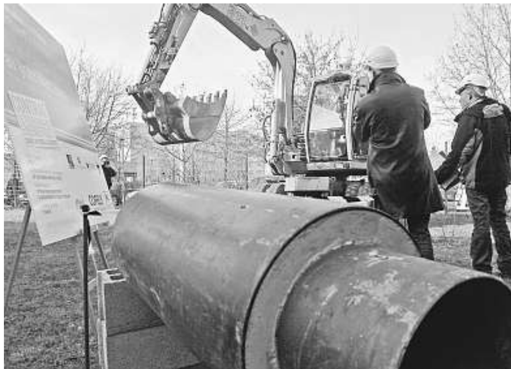
Lancement des travaux induits par le contrat de performance énergétique, hier au lycée Marc-Bloch à Bischheim. (Photo DNA-Bernard Meyer)
